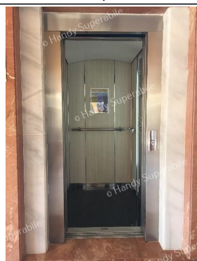
Ascensore blocco A
